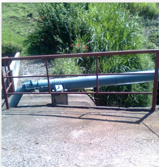
Tubería de distribución de agua. Sistema los Arcos, Real Cariari, Heredia.
