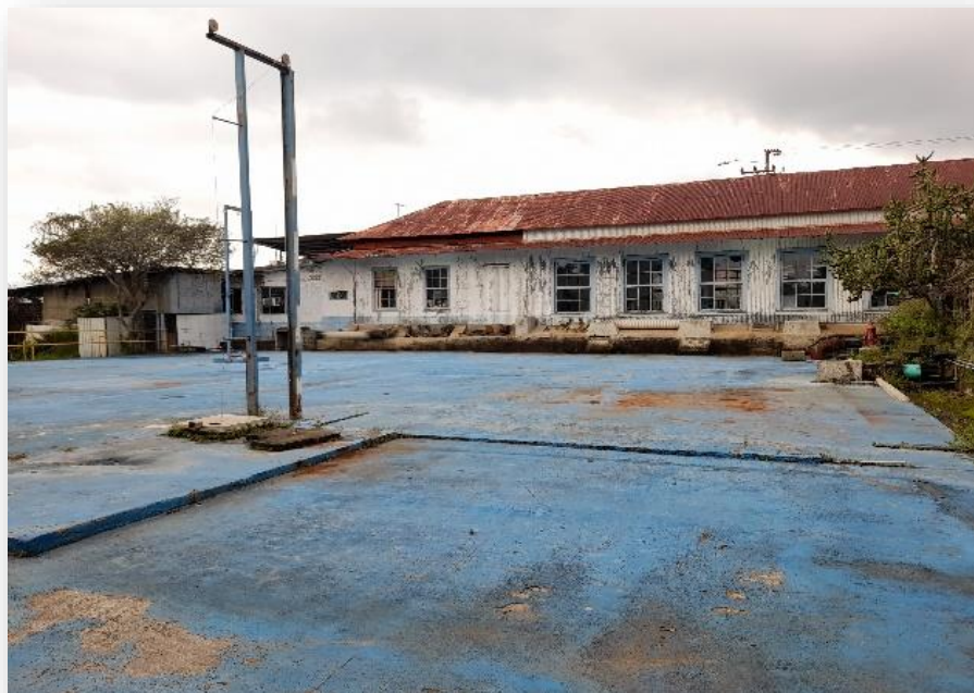
Ilustración 12. Tanque la Joya cerrado. Volumen 2000 m3. San Josecito de San Rafael de Heredia.
