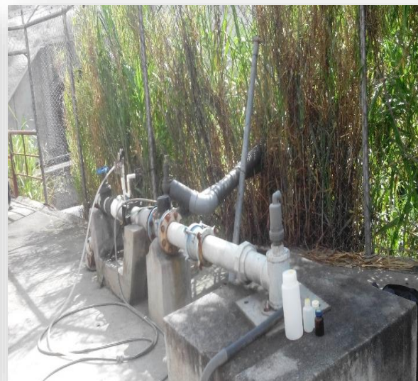
Pozo del sistema de agua potable Los Arcos, Real Cariari, Heredia
