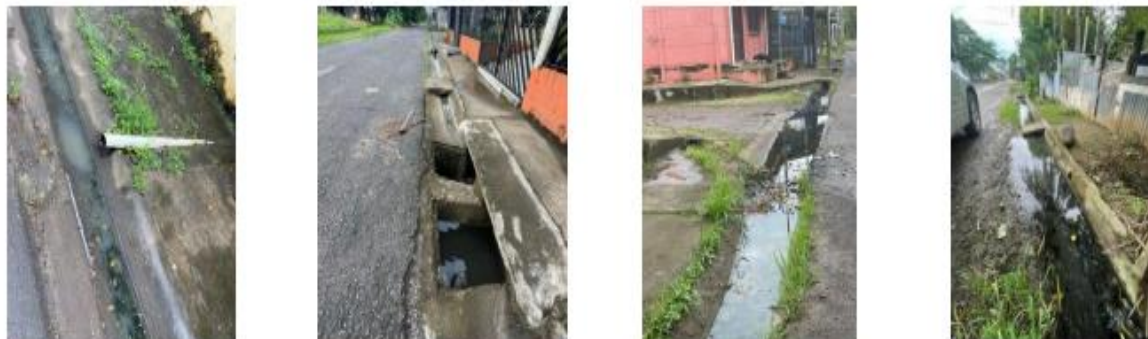
Figura 6. Vertidos ilegales de agua residual, Comunidad de Juanito Mora y Manuel Mora, año 2022.
